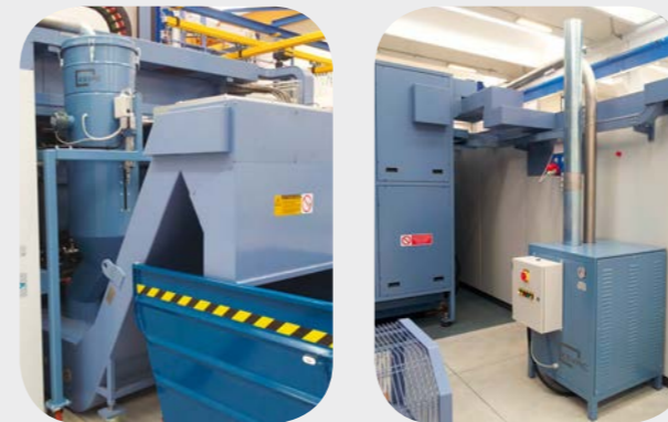
Réseau centralisé pour l'aspiration de copeaux sur plusieurs postes opérateurs avec déchargement automatique sur convoyeur d'évacuation à tapis métallique
